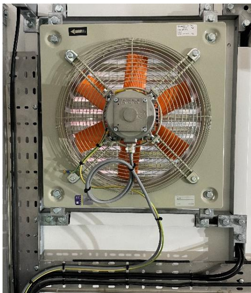
ATEX-rated Ventilation Fan
